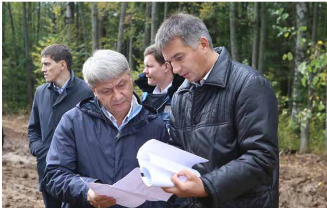
Генеральный директор Общества изучает ход работ на перемычке между МГ Уренгой–Петровск и Поляна–КСПХГ
